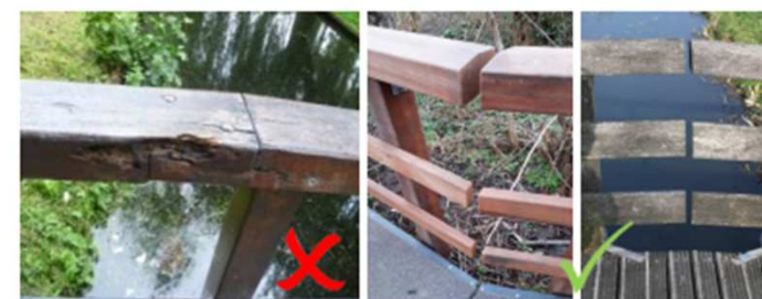
Figuur 4.13 Brugleuningen: Links : Vochtphoping door capillaire werking tussen brugleuningen (CUR 117); Midden en Rechts : Brugleuning luchtig detaillering (CHEdM)
