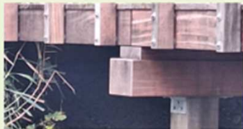
EPDM als bescherming nog niet aanwezig ter bescherming houten delen
